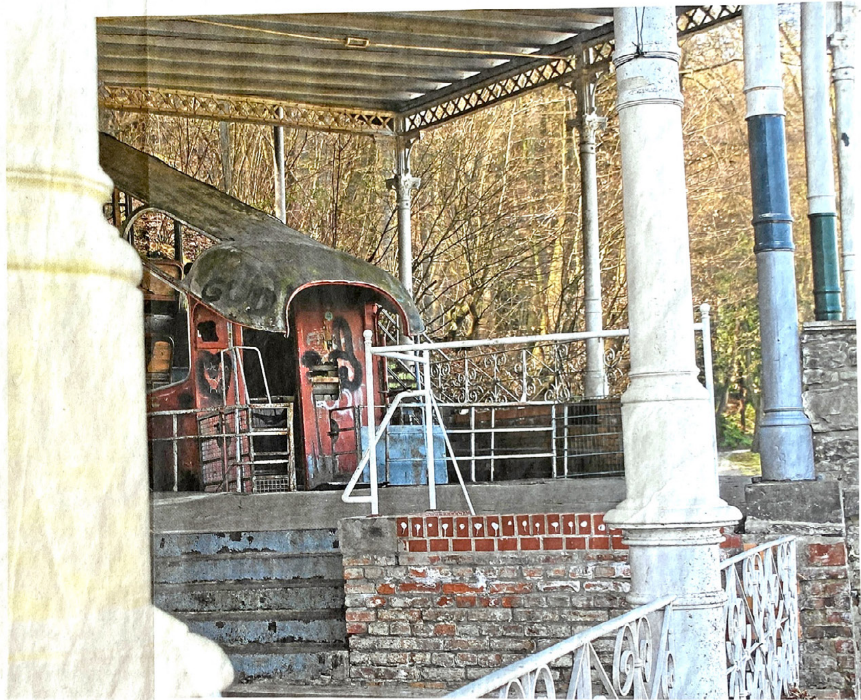
Eierschalenfarben, weiß, anthrazit? Einige Farben wurden bereits an den Säulen getestet. Auf einen Nenner sind die Obere Denkmalpflegebehörde in Mainz und die Förderer der Malbergbahn noch nicht gekommen. Doch die Entscheidung soll nun schnellstmöglich fallen.
